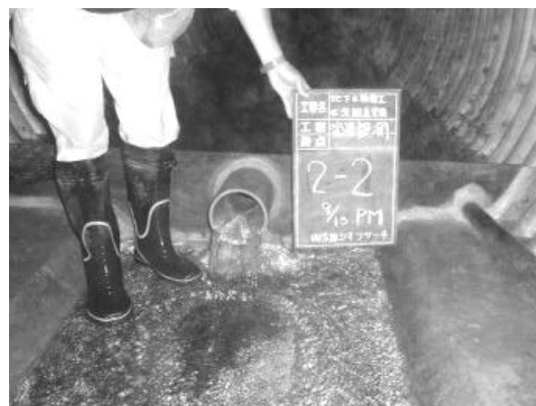
写真-1 排水トンネル内に設置した流量観測堰
